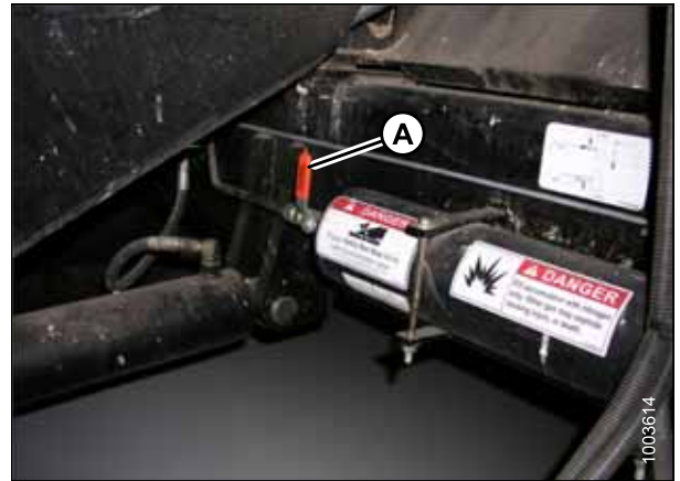
Abbildung 3.205: Absperrhebel für Druckspeicher A – Druckspeicherhebel (Stellung „Geschlossen“)
